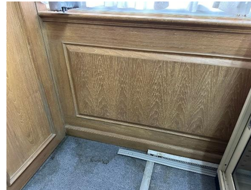
ห้องปาล์มไพลิน บริเวณด้านข้างเวทีมีน้ำซึมจากข้างนอกเข้ามากรณีที่ฝนตกหนัก
