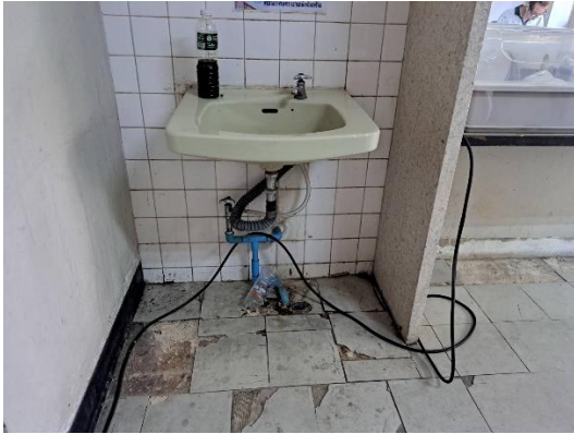
สายไฟบริเวณห้องรับประทานอาหาร (อาคารสี่)
