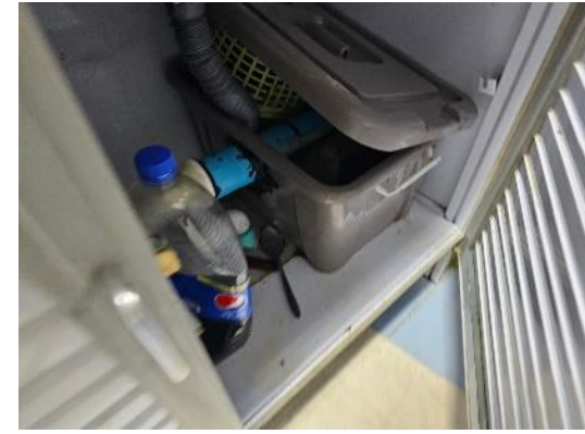
ควรทำความสะอาดถังดักไขมัน
