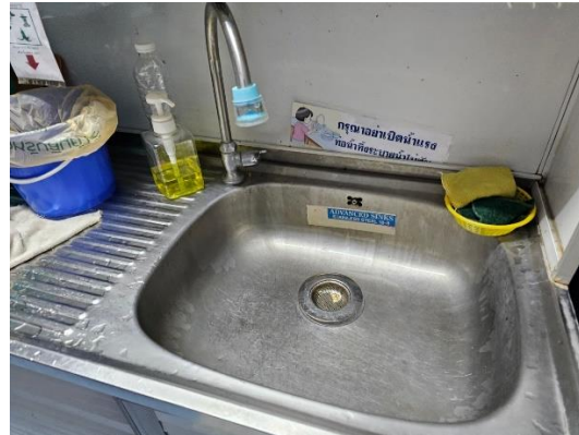
ควรมีการทำความสะอาดบริเวณอ่างล้างจาน
